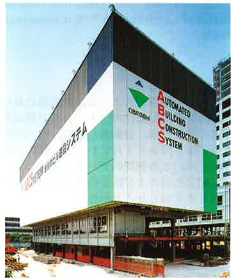
写真-1 SCF 外部
