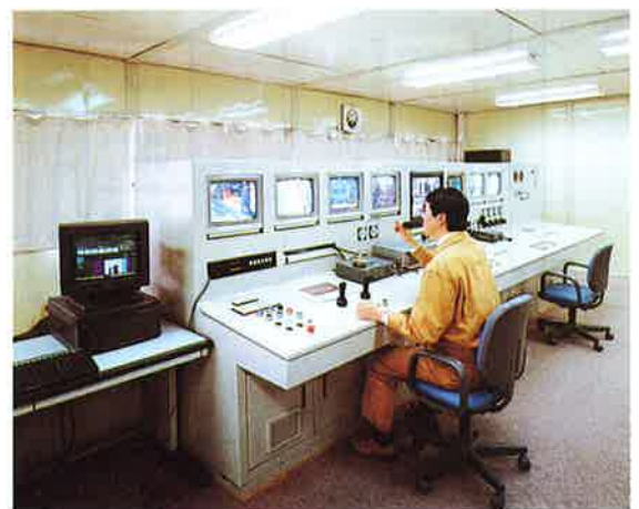
写真-8 中央制御室
