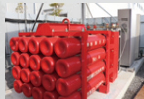
水素発電設備
