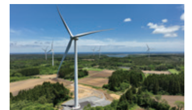
上北小川原風力発電所
