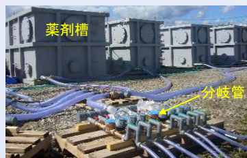
図12 クロロクリンL注入設備
