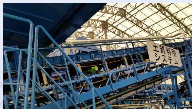
写真4 土質判別システム設置状況
