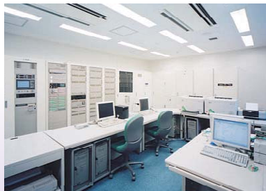
複数棟間のネットワークにより効率的な施設運営を可能にするオープンネットワーク制御システム「FRiGATE(フリゲート)」(神奈川県立保健福祉大学)
