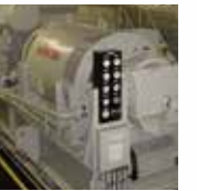
非常用発電機
