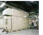
コージェネレーションシステム
