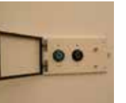
非常用医療ガスアウトレットイメージ
