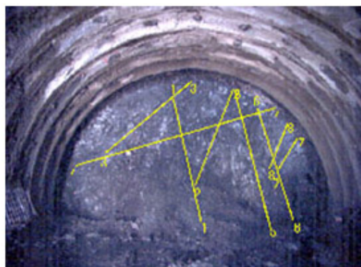
周辺に分布する亀裂を正確に抽出できます
