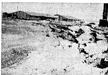
図-15 へドロ上まき出し土の陥没流動状況(堺)
