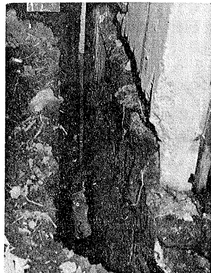
写真一2 壁体破壊時に生じた地盤と壁体との間隙
