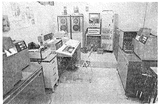
写真-1 システム全景
