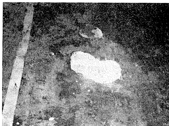
写真一2 スラブ上面：局所的な圧壊
