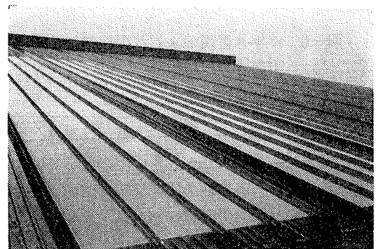
写真-2 流下式集熱器の外観
