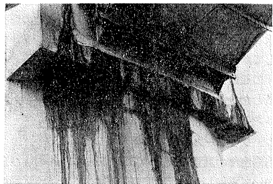
写真一1 煙突と煙道との取合い部の状態
