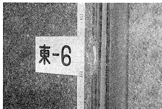
写真-3 コンクリートの欠け
