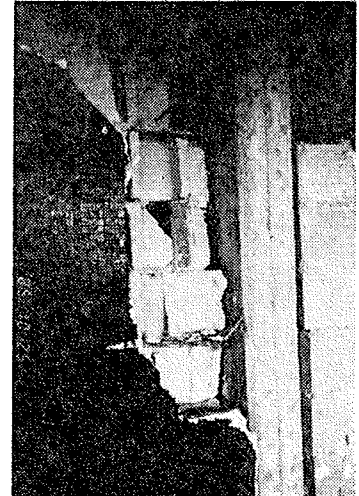
写真-13 間仕切りブロック壁 (鉄筋径は13mm程度)
