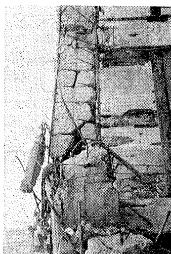
写真一5 柱の圧壊 (帯筋がほどけている)
