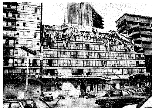
写真一3 上層部のパンケーキ状崩壊 (カーテンなどが垂れ下がっている)
