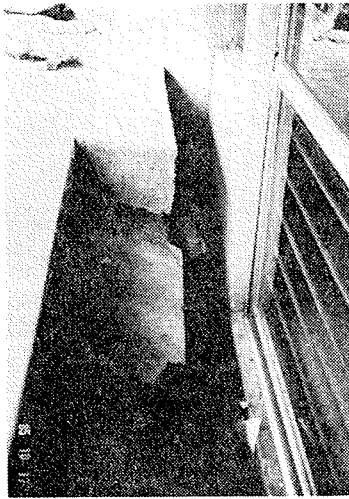
写真-8 建物の沈下 (左側の道路より90cm沈下)
