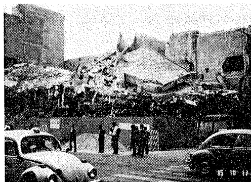
写真一2 パンケーキ状崩壊 (片付けもなされていない)
