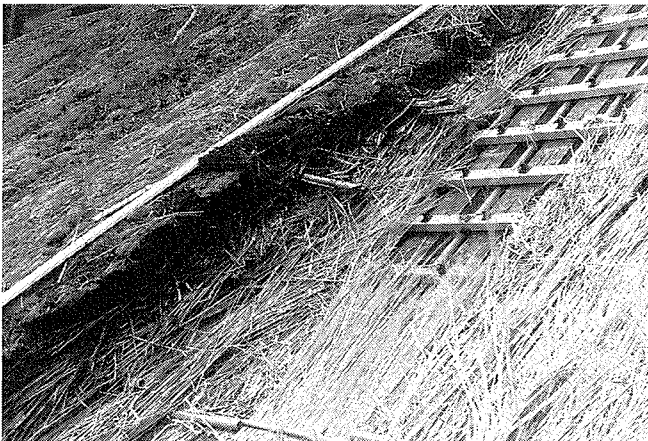
写真-1 某殿舎の腐朽した萱葺屋根の内部の状況
