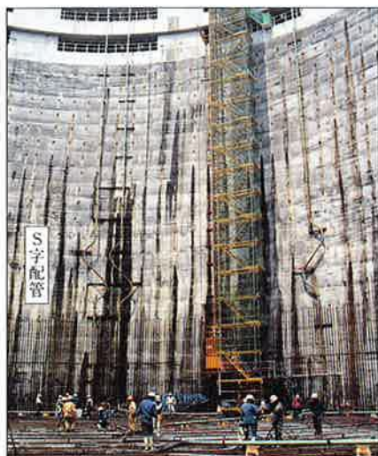
写真-3 鉛直配管
