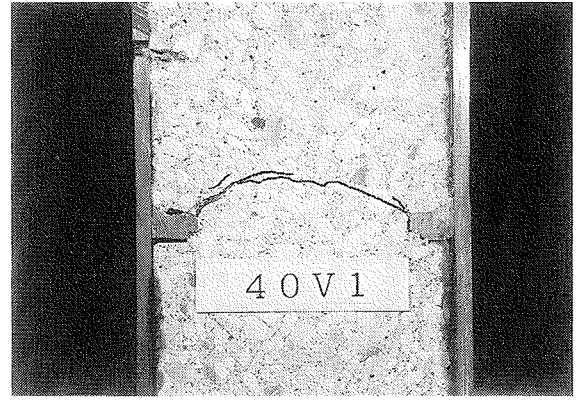
写真-1 鋼管内部の損傷状況
