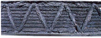
Photo 4 トラスの発泡状況 (ケース5) Swelling of Paint on the Truss
