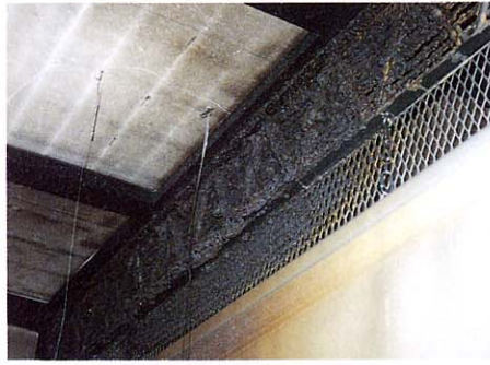
Photo 2 耐火塗料の発泡状態 (ケース1) Swelling of Intumescent Paint (Case 1)
