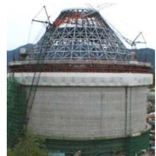
Photo 1 某石炭サイロ工事 スリップアップ工法の様子 Construction of a Silo
