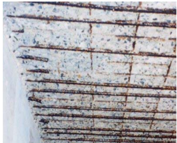
Photo 1 雑排水槽におけるコンクリート腐食の事例(天井スラブ下面) Corrosion of Concrete by H_2S Gas
