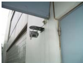
Photo 2 監視カメラ Security Camera
