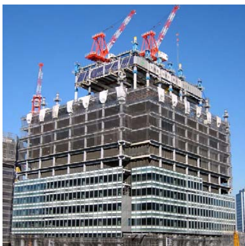
Photo 3 併用型ABC Sによる施工中の建物外観 Building of Project O under Construction
