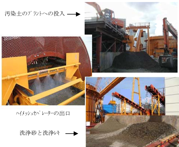
Photo 1 分級洗浄プラント Class Washing System
