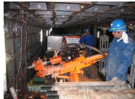
Photo 3 施工性確認試験の状況（高さ1.7m） Field Test of Development Machine
