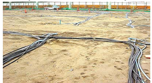
Photo 1 浄化用井戸への配管状況 Pipe Laying for Well for Clean up
