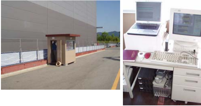
Photo 1 振動監視システム設置例（設置小屋外観・内観） Setting Example in a Small Cabin
