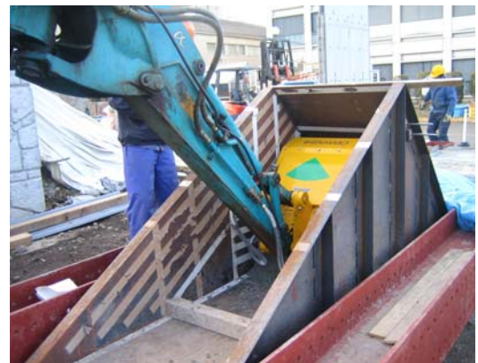
Fig. 8 プレートコンパクターによる締固め試験 Compaction Test by Plate Compactor
