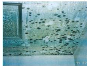
Photo 1 地下室の結露事例 Case of Basement
