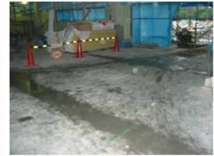
Photo 2 倉庫の結露事例 Case of Warehouse
