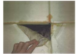
Photo 4 機械室の結露事例 Case of Machine Room
