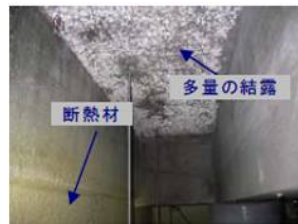
Photo 3 ヒートブリッジ結露 Case of Heat Bridge Type
