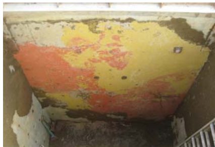
Photo 11 南壁における界面注入体の露頭状況 Externals of Interface Layer Formed the Second Injection
