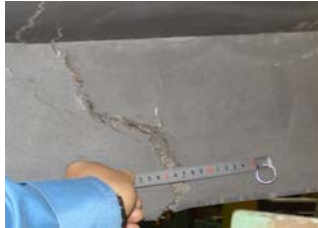
Photo 11 最大変位時のひび割れ Crack at Maximum Displacement
