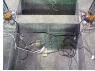
Photo 10 底部を貫通したひび割れ Crack through the Bottom Flange
