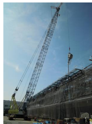
Photo 7 CFT柱のコンクリート打設状況 Application of Fresh Concrete into a CFT Column
