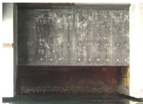
Photo 17 被災後の梁部「スリムクリート」 Slim Creat beam after the earthquake disaster
