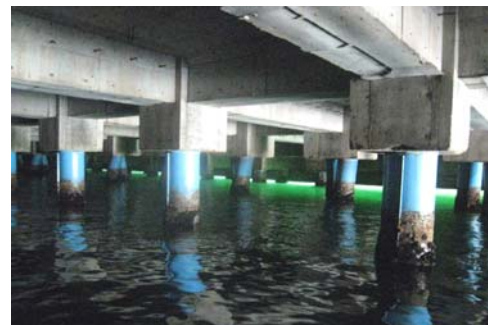
Photo 9 補修した棧橋構造物の下部 Lower part of the repaired pier
