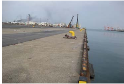
Photo 3 東日本大震災直後の雷神埠頭の状況 (平成23年3月14日撮影) Raijin Wharf after Earthquake and Tsunami Attack
