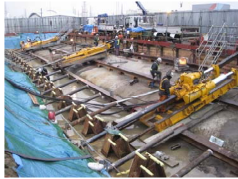
Photo 2 小口径削孔機による補強タイ材施工状況 Drilling work for Retrofit Tie Members
