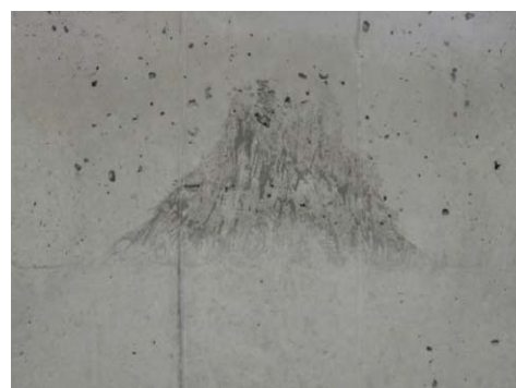
Photo 12 型枠に付着したモルタルの跡 Trace of Mortar Adhering to the Form
