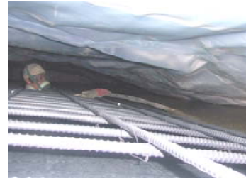
Photo 2 トンネル覆工のコンクリートの打込み状況例 Example of Construction Situation of Tunnel Lining
