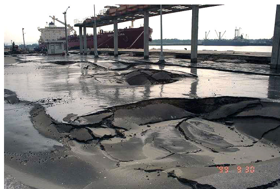
Photo 16 液状化による被害 Damage Caused by Liquefaction
