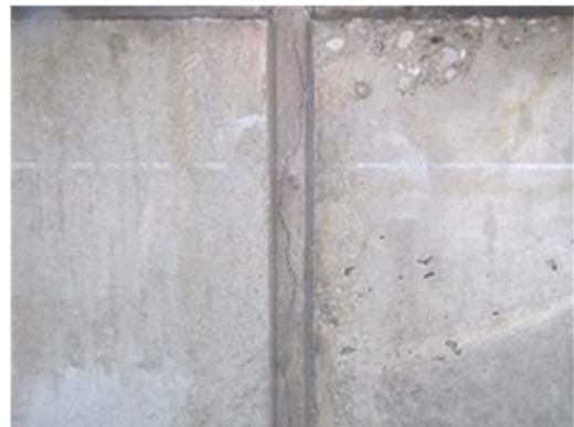
Photo 1 誘発目地に発生したひび割れの状況 Concrete Crack of Crack Control Joint Position
