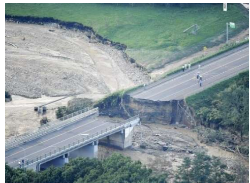
Photo 1 2016年台風10号によるペケレベツ川の増水で流出した道路(北海道清水町, 読売新聞社撮影) Road Damaged by Flood of the Pekerebetsu River due to a Typhoon Lionrock in 2016
