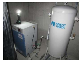
コンプレッサ・空気タンク
