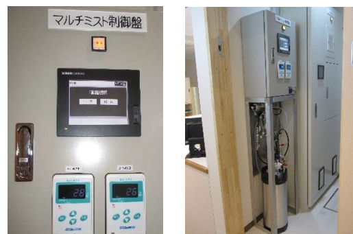
制御盤(タッチパネル) 制御盤・液タンク
