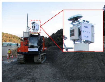
Fig. 7 アンテナ方向制御装置 Antenna Direction Control Device
