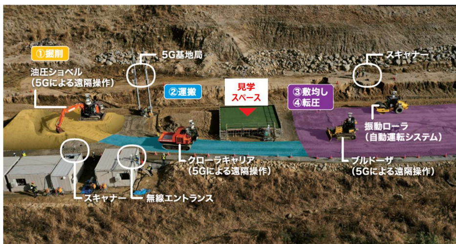
Fig. 4 試験エリアにおける機器配置 Equipment Layout in Test Area
