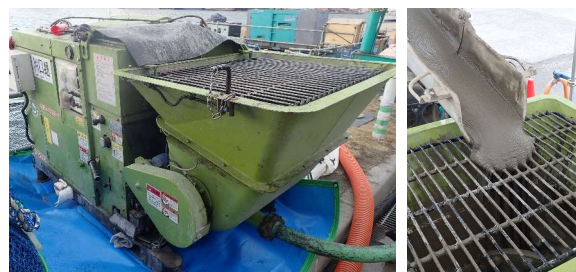
Photo 7 使用したポンプとモルタルの荷卸し状況 Used Pump and Mortar Unloading Situation
