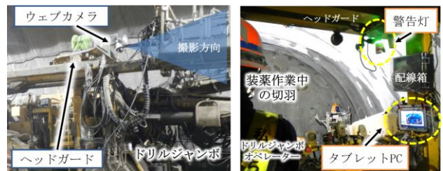
Photo 2 ロックフォールファインダーの設置状況 (Bトンネル, 左は重機右側, 右は運転席から撮影) Rock Fall Finder Installation Example (B Tunnel)
