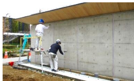
Photo 1 シェルトクリヤの塗装状況 Painting Status of Shelt-Clear
