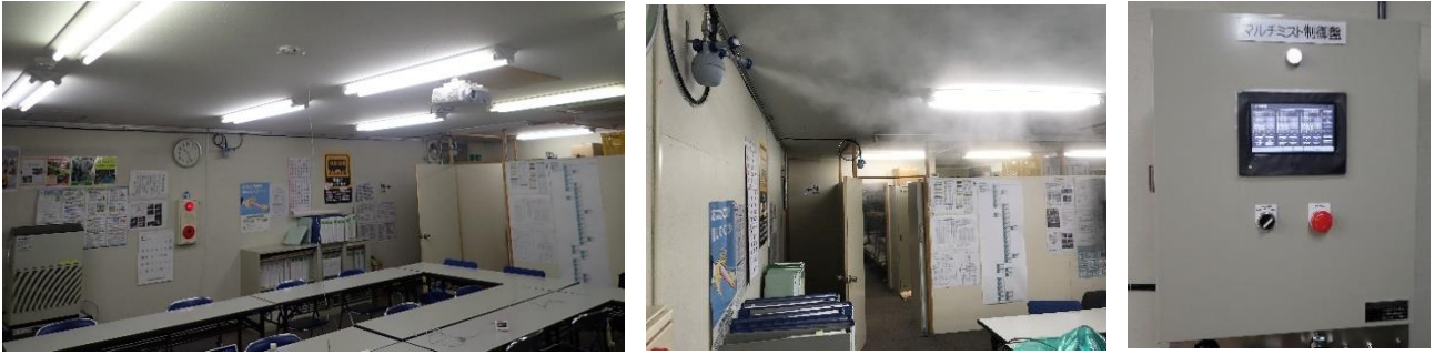
Photo 3 工事事務所 マルチミストビルトイン Built-in Multi Mist at the Site Office
