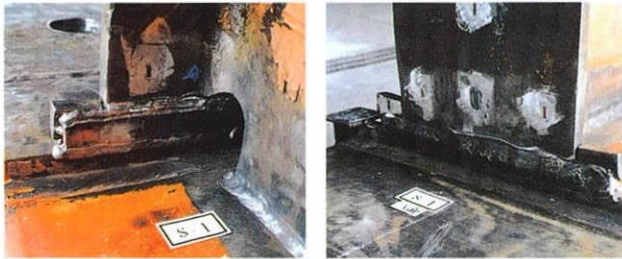
1) スカラップ底からき裂発生 Cracking Growth from Toe of Weld Access Hole 2) フランジ熱影響部の破断 Fracture at Heat Affect Zone of Beam-Flange
