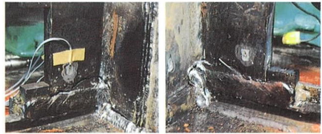
1) 充填溶接付近からき裂発生 Initial Cracking from Adjacent Replacing Web-Plate 2) フランジ熱影響部へき裂進展 Fracture at Heat Affect Zone of Beam-Flange in Brittle Manner
