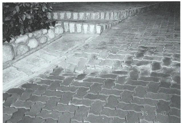
Photo 15 外構インターロッキングブロックの被害 Damaged Interlocking Block of External Pavement
