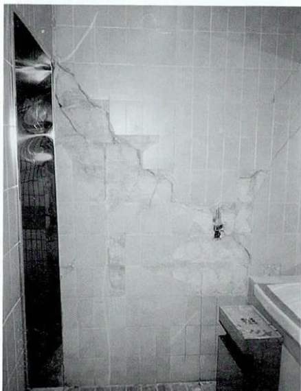
Photo 11 タイル張りの被害（2） Damaged Interior Tile
