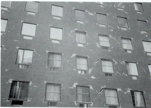
Photo 10 タイル張りの被害（1） Damaged Exterior Tile
