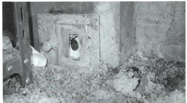
Photo 1 ファスナー用ボルトの破断 Failure of Bolt
