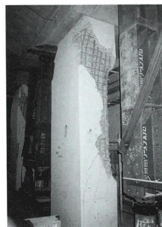
Photo 1 柱の被害状況 (ランク I) A Damaged Column (Rank I)
