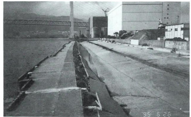
Photo 3 被災状況（東部第4工区） Damage to Quaywall (No. 2)
