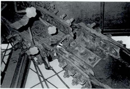
Photo 4-2 鉄骨ブレースの被害詳細 Detail of SRC Brace's Damage
