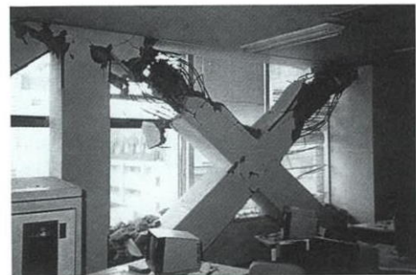
Photo 4-1 鉄骨ブレースの被害 Damage of SRC Brace
